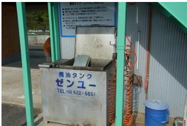
廃油タンク・エアー
