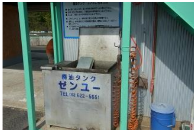
廃油タンク・エアー
